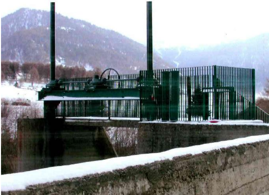
Figura 5: Organi di manovra dello scarico di fondo.
